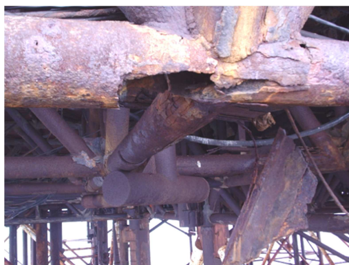
Рис. 3. Трещины коррозионной усталости
