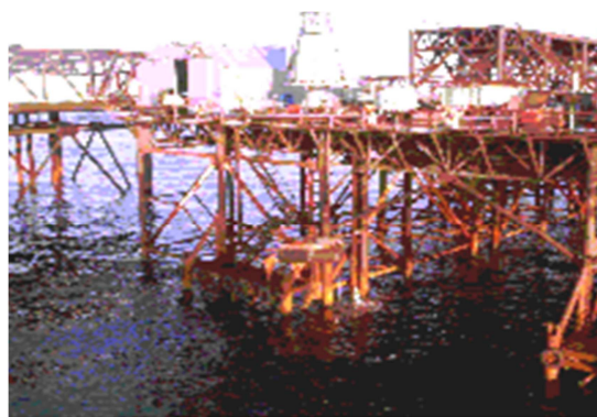
Рис.2. Сплошная коррозия морской платформы
