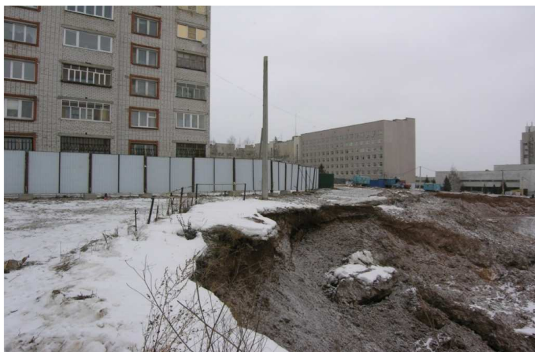
Рис. 5а. В процессе инженерной подготовки строительной площадки искусственно созданы зоны геологических опасностей с техногенными оползнями (6 микрорайон, г. Чебоксары).
