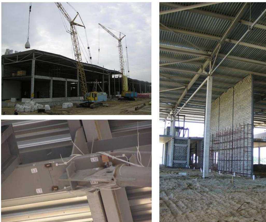
Рис. 5 – Натурные испытания конструкций нагружением с контролем относительных деформаций (тензометрические преобразователи) и перемещений (шкаловые марки)
