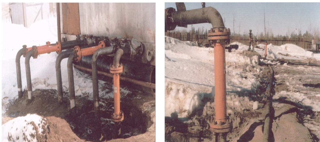
Рис.3. Магнитные камеры на устье и на входе в ГЗУ «Спутник»
