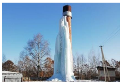
Рис. 3. Ледяные наросты на водонапорной башне
